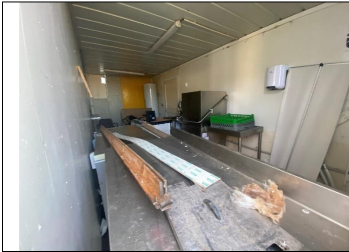
Chambre froide démontée environ 2m x 2,50 m
